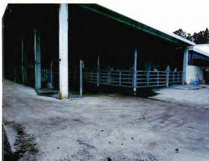
牛舎に設置された防鳥ネット
